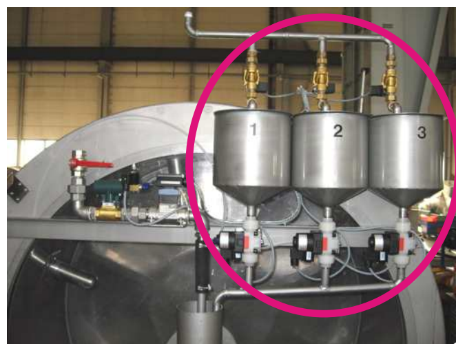
Behälter für automatische Dosierung
